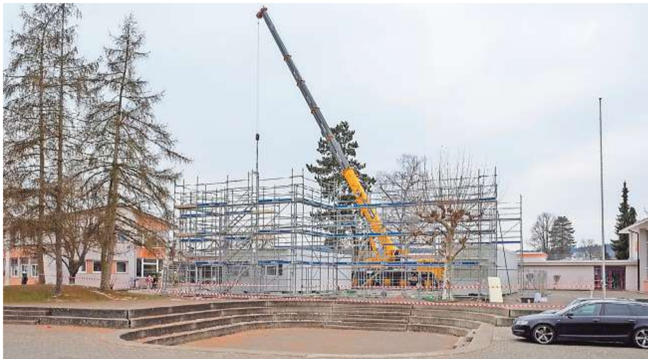
Aufbau der insgesamt 16 Container-Schulzimmer auf dem Schulareal Erlenweg in Oberentfelden. Ein Teil des Pausenplatzes fällt der provisorischen Lösung zum Opfer. BILDER: SCHULE ENTFELDEN
