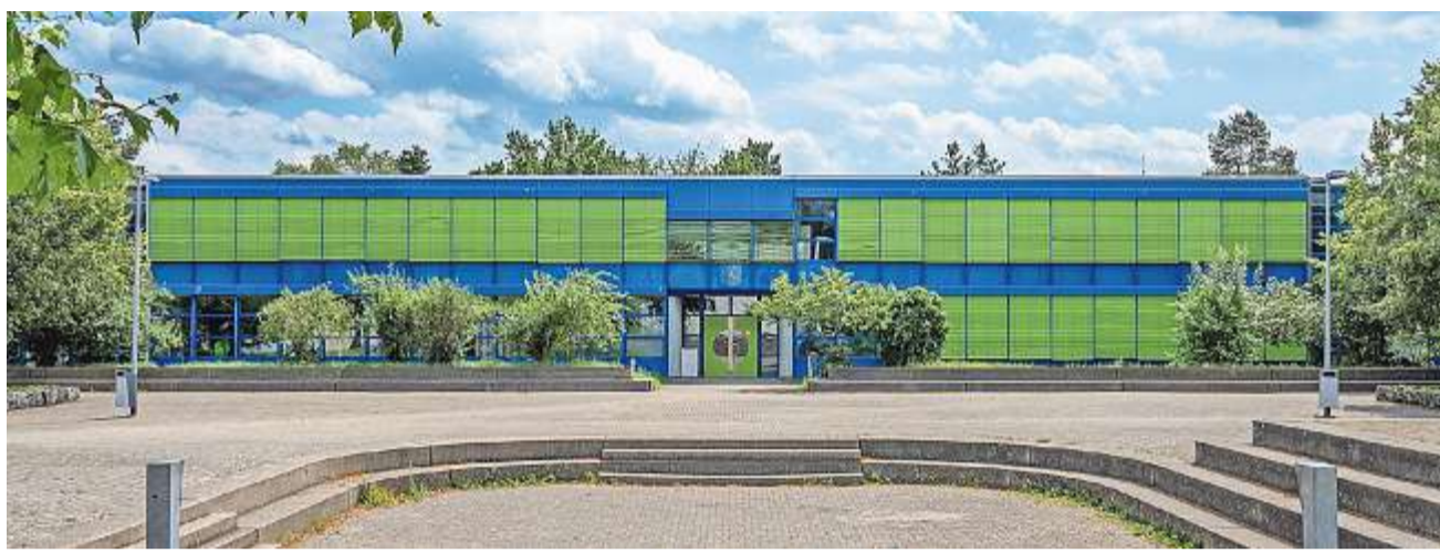
Ist sanierungsbedürftig und bietet zu wenig Platz: Das heutige blaue Oberstufenschulhaus in Oberentfelden.
